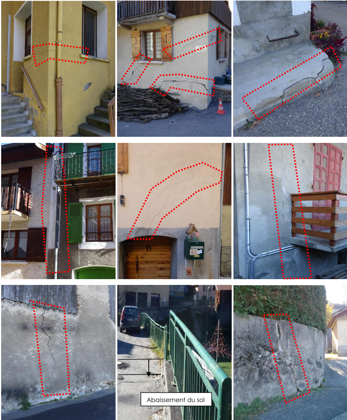
Figure 2 : Suite de photos non exhaustives relatant les désordres constatés en centre village
