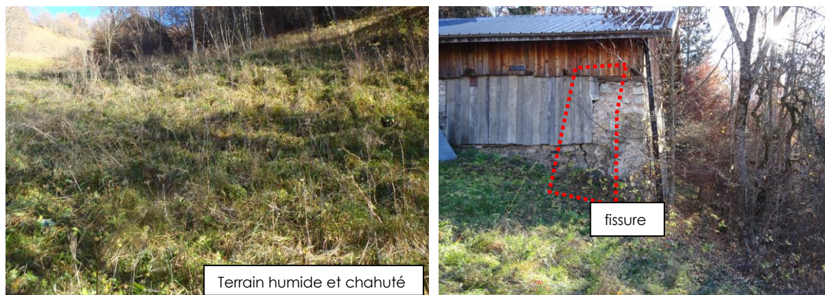
Figure 13 : désordres constatés sur les Combes d'en Haut
